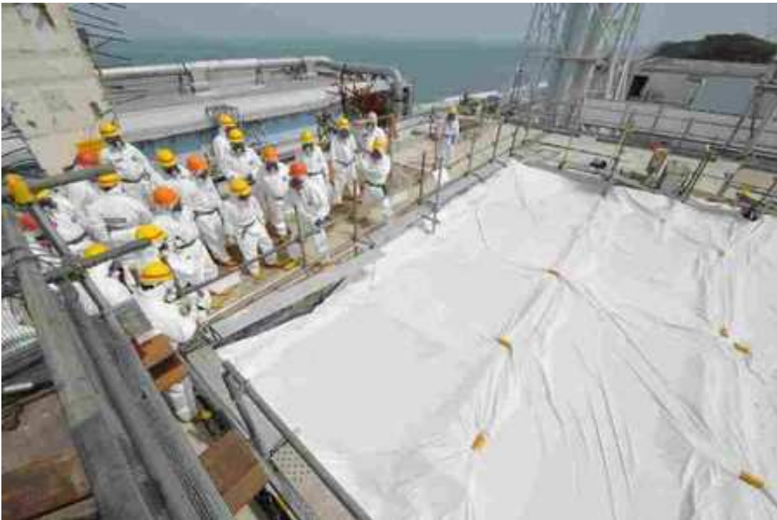
Le ministre et les journalistes sont debout auprès du réservoir d'immersion des barres de combustible que recouvre ce qui semble n'être qu'un simple plastique.
