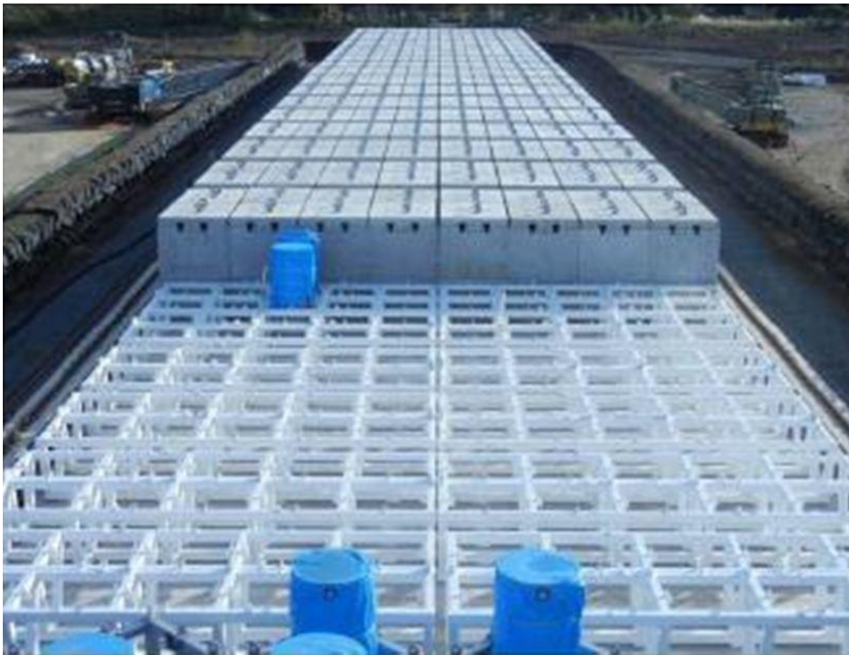
セシウム吸着塔一時保管施設設置状況 (シートで梱包されているセシウム吸着塔は未使用品)
